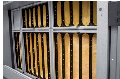
Specjalnie wykonane filtry ze specjalnego włókna, klasa F9. Mocowanie filtrów zapewnia wysoką szczelność.
